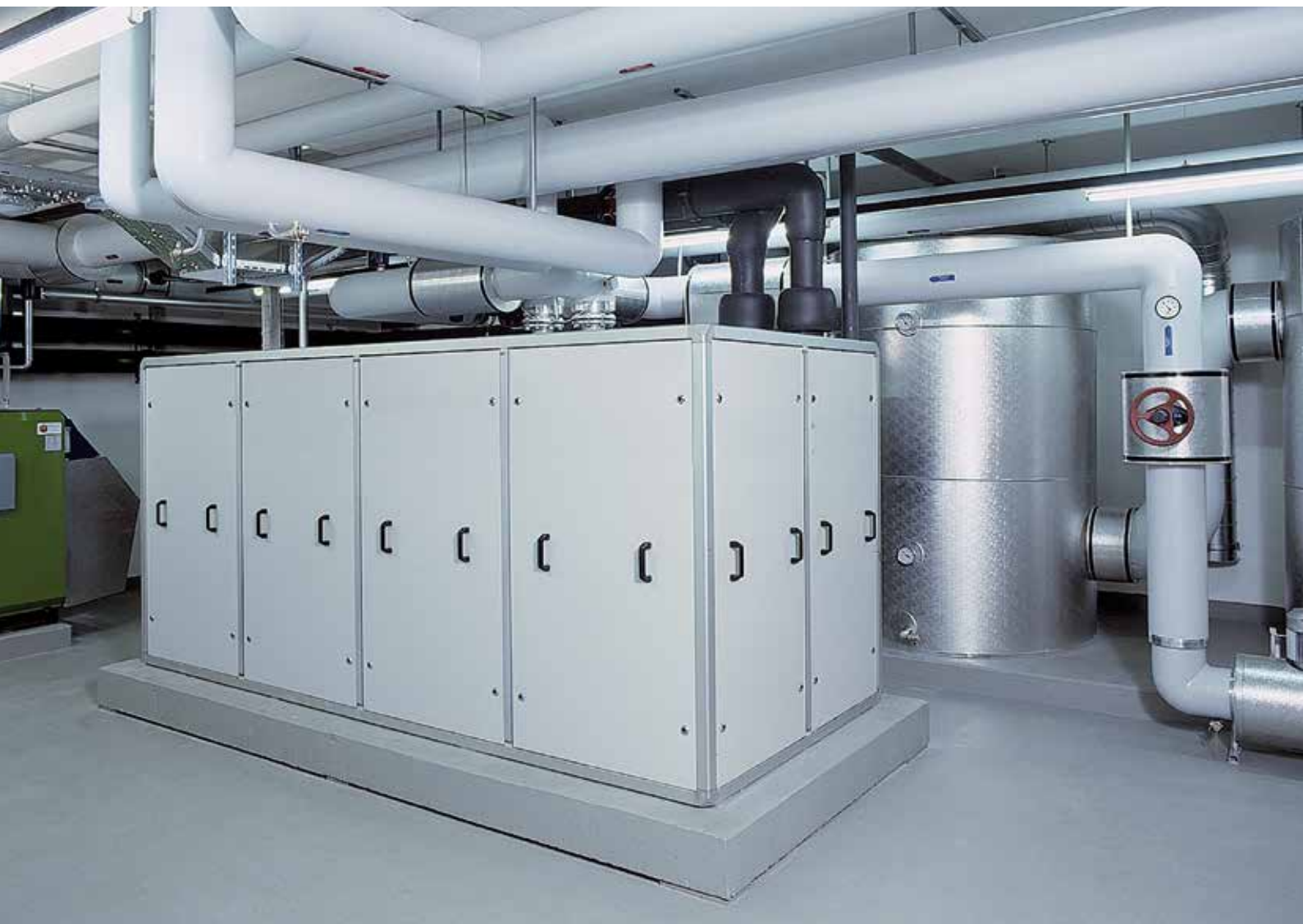
Tepelné čerpadlo země/voda s topným výkonem 290 kW.
